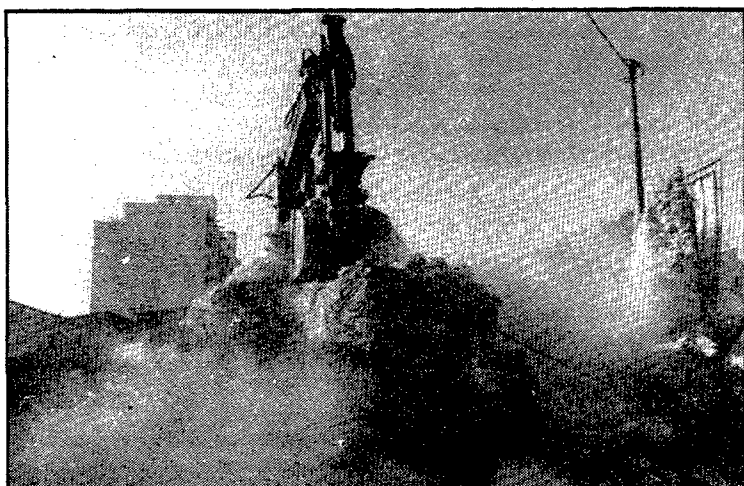
L'antiga rectoria de Santa Eugènia va anar a terra el novembre de 1981, cent setanta anys després d'haver estat construïda. Era el número 2 del carrer de les Guilleries (Foto: arxiu de PUNT DIARI)
